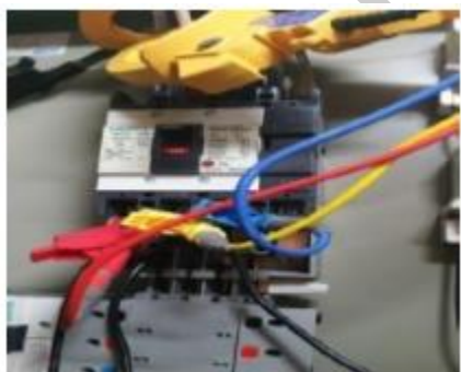
สถานที่ติดตั้ง : ทั้งสองข้างของ VCB ต่อแบบคู่ขนาน
